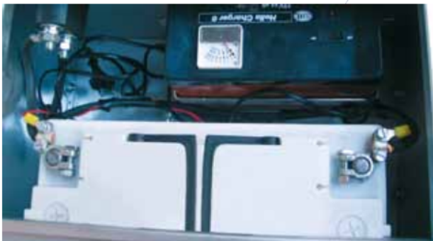
Batterie avec chargeur 230 Volt
